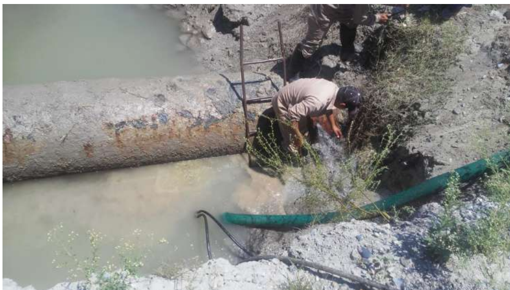
Figura 2.14 Fuga de línea de concreto pretensado en la llegada a Rebombero 1. agosto 2019
