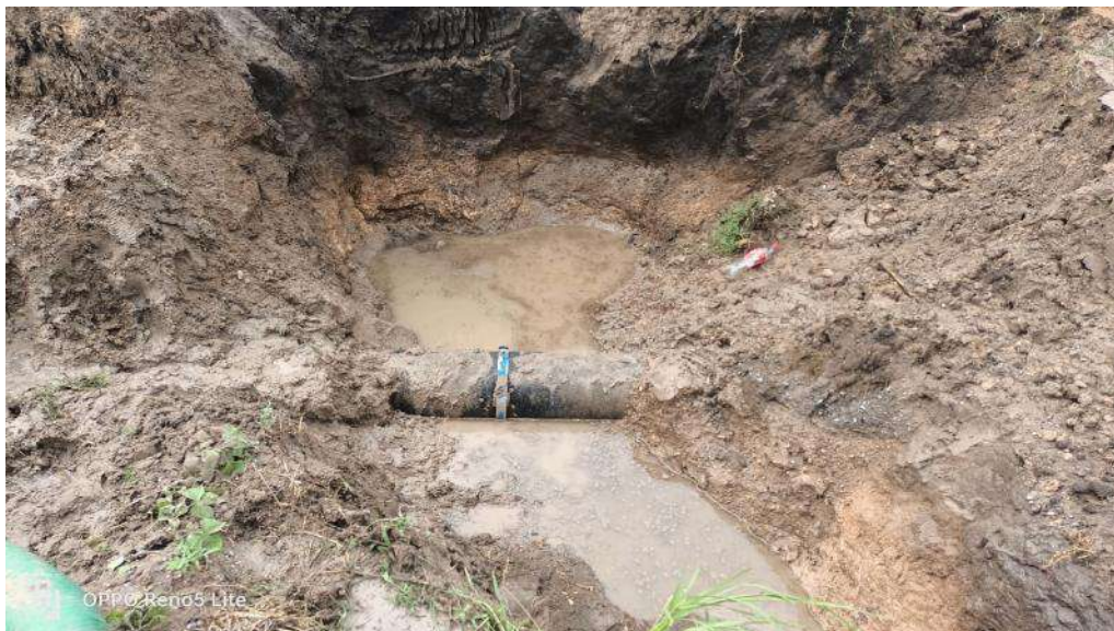
Figura 2.13 Fuga en tubería de acero de 16 pulgadas de diámetro en la descarga del equipo #4, P. Bombeo 2. (13 de mayo del 2023).
