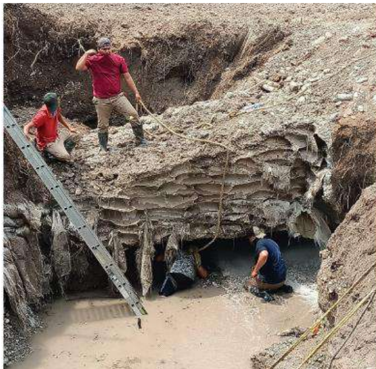
Figura 2.12 Fuga en el acueducto en el arroyo El Sarnoso, aprox. km 33.3 carr. Victoria - Soto la Marina 21 de abril 2023
