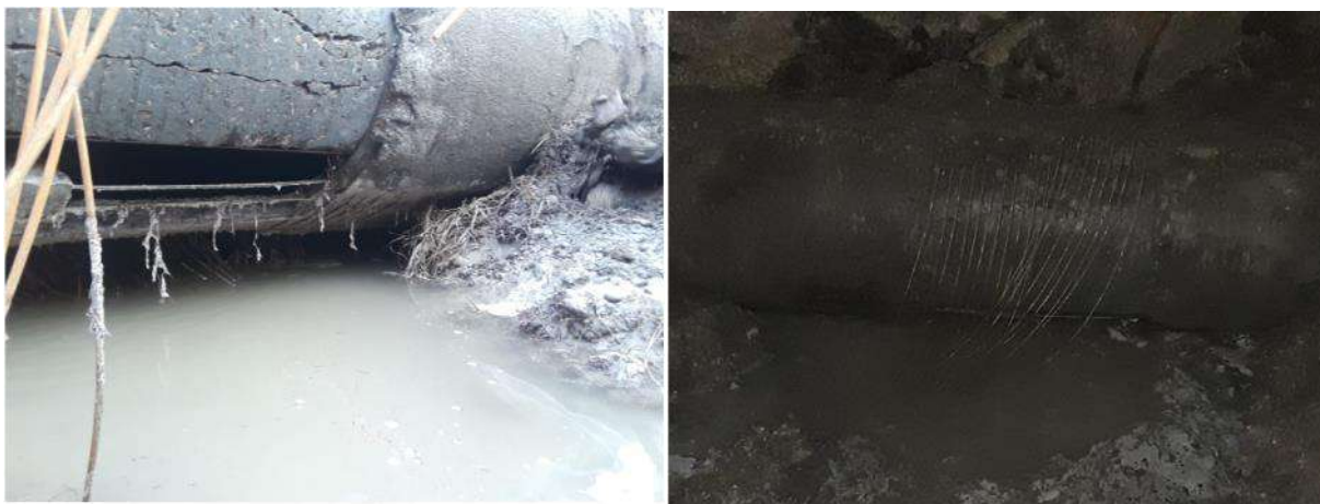
Figura 2.10 Falla del acueducto en tramo de concreto, fatiga de material, perdida de recubrimiento y refuerzo, aprox. km 23 carr. Victoria - Soto la Marina. Suspensión del servicio de agua potable en un 70% de las colonias de la ciudad. 15 dic 2021
