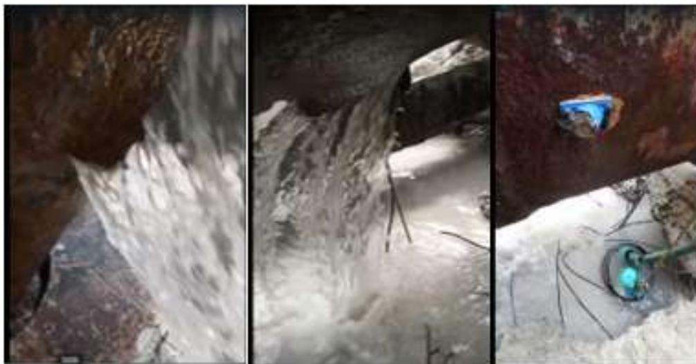
Figura 2.9 Falla del tubo en caja de válvulas, interior en R1, después del múltiple, 11 febrero 2021
