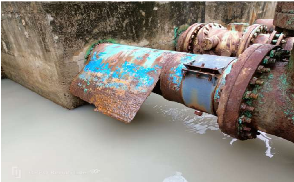
Figura 2.11 Fuga en cámaras de aire del rebombero 1, fatiga de material carrete de acero. 14 mazo 2023
