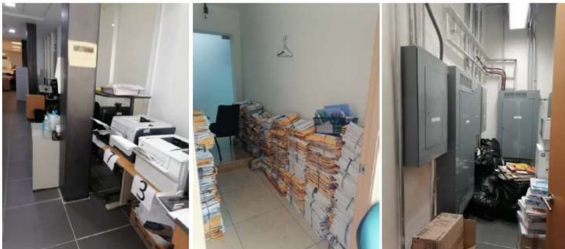
SE OBSERVAN ESPACIOS OCUPADOS E INVADIENDO RUTAS DE SALIDA
